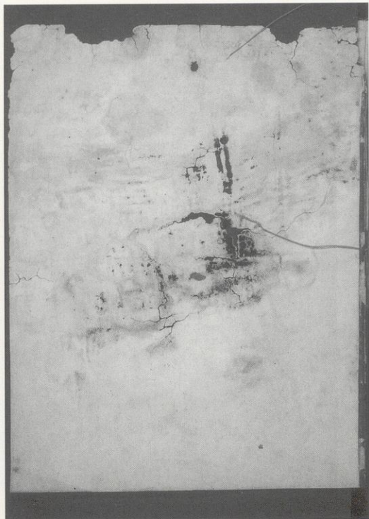
Abb. 3: Verfärbungen und Substanzverlust durch Schimmel
