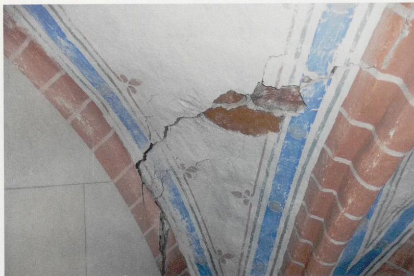
6 Riss in Putz und Mauerwerk des Gewölbes
